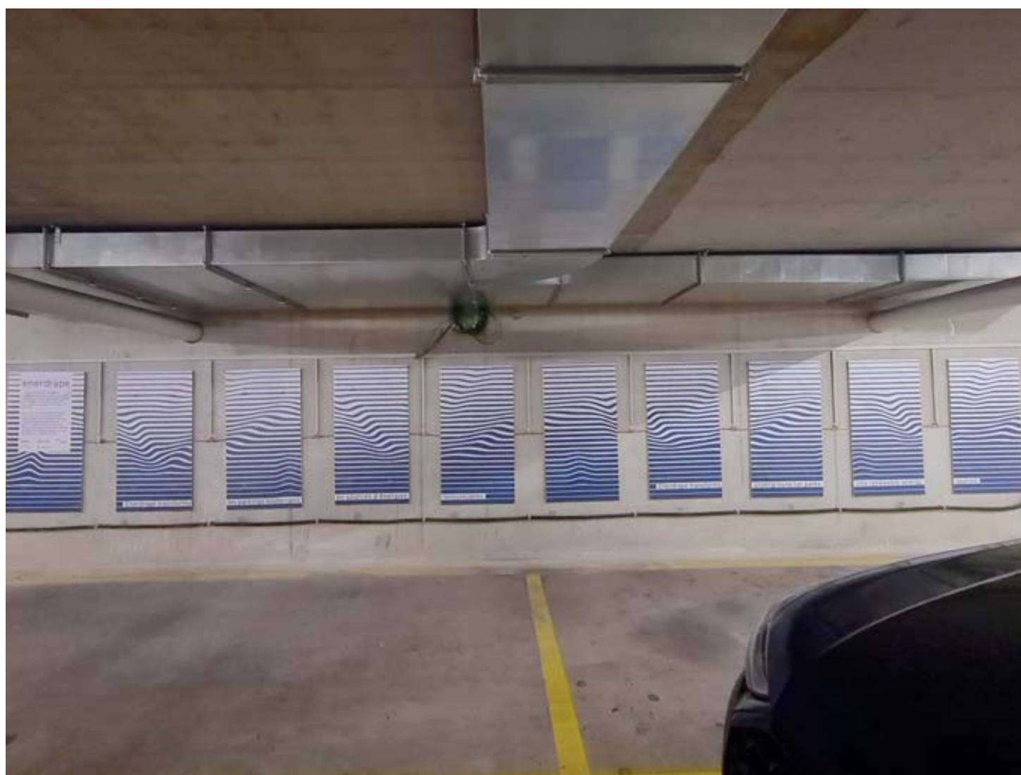
Des panneaux apposés, par exemple, sur les murs des parkings souterrains permettent de «collecter» la chaleur et d'utiliser ensuite cette énergie. Le spin-off Enerdrape travaille à commercialiser son produit dès l'an prochain. ENERDRAPE/DR
