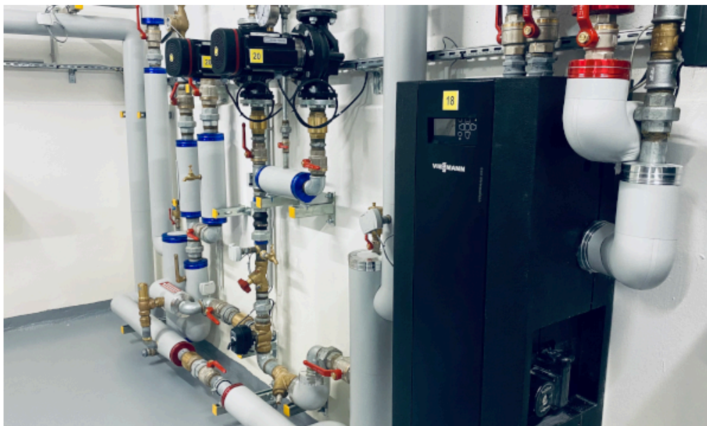
L'eau venant du ballon d'eau préchauffée et ensuite mélangée à une eau chauffée au gaz pour être envoyée, à 60° environ, dans les logements. © Jgp
