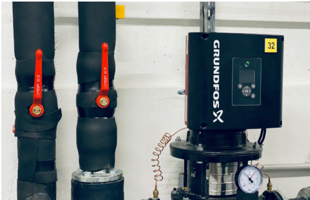
Une pompe fait circuler un fluide dans les panneaux. En cette journée de février, l'eau part à environ 1,8°C et revient à 5,9°C. Une pompe à chaleur fait ensuite monter la température à 40°. © Jgp
