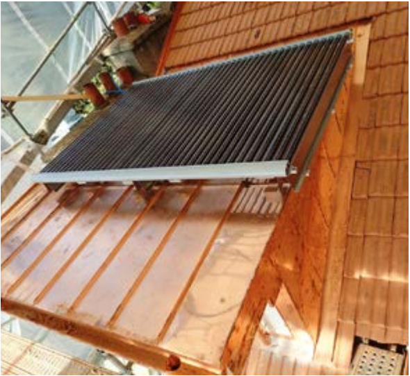
Capteurs solaires à tubes sous vide.
